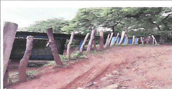
Foto 2: serco de alambre de puas en mal estado
